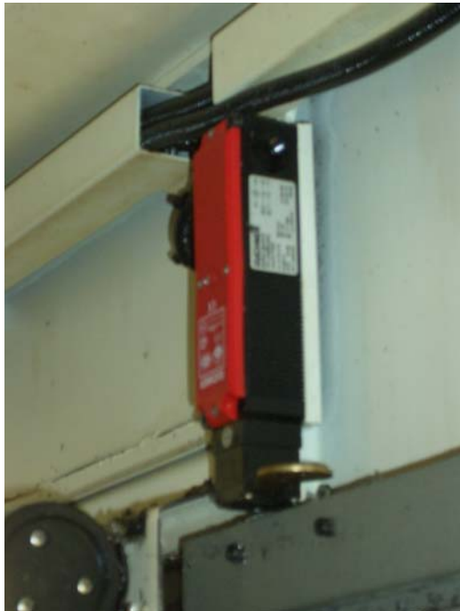
Abbildung 5: Manipulation eines Positionsschalters an einer Schutztür
